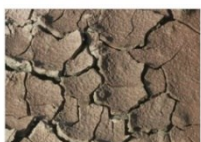
retrait- gonflement des argiles
